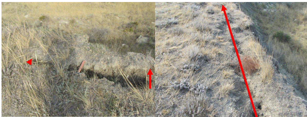
Рис. 3: Мониторинг расширения трещины у пешеходной тропы, профиль ТН-1
